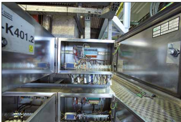
Obr. 3. Pohled do jedné z modernizovaných skříněk systému řízení kotle K4 umístěných v provozu (moduly I/O systému B&R X20, oddělovací moduly ZAT, napájení; vlastní skříňka a silová kabeláž zůstaly původní)
