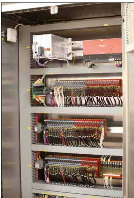
Obr. 4. Skříň řídicího systému bagrovací stanice (nahore vana 9304/01 s řídicí jednotkou ZAT DV300, komunikační jednotkou ZAT DV702 a napájením; pod vanou na lištách I/O moduly B&R X20 a oddělovací moduly ZAT-MD)
