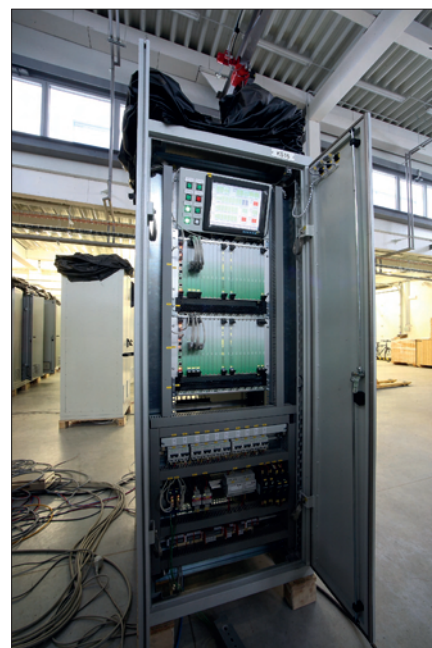
Obr. 4. Rozváděčová skříň se dvěma řídicími stanicemi Z200
