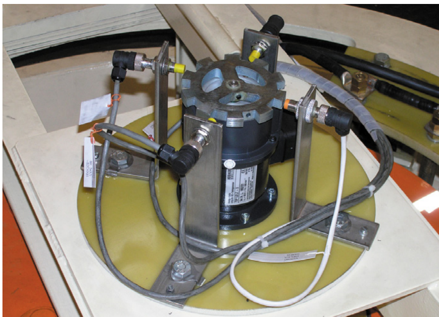
Snímání otáček turbíny (pomocí čidel z ozubeného věnce na elektrárně Dalešice)
