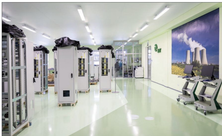
Obr. 2. Nové výrobní prostory pro montáž rozváděčů
