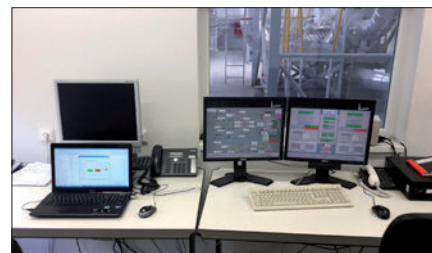
Obr. 9. Pracoviště trenažéru topiče záložních kotlů
