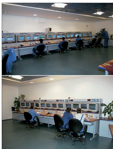
Obr. 3. V letech 1998 až 2012 byla sloučena operátorská pracoviště (z jednoho pracoviště se řídily dva kotle nebo dva turbogenerátory) a přemístěna do společného velínu
