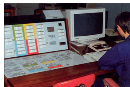
Obr. 2. V letech 1991 až 1998 byla EOP kompletně osazena řídicím systémem ZAT E a ZAT D s operátorskými stanicemi Geadat Z300, později InTouch
