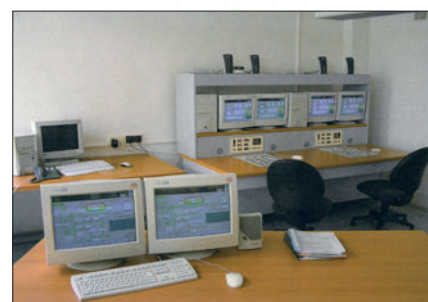
Obr. 5. Pracoviště trenážeru kotlů
