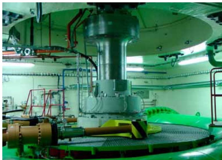
Vodní elektrárna Lipno I, víko spirály
